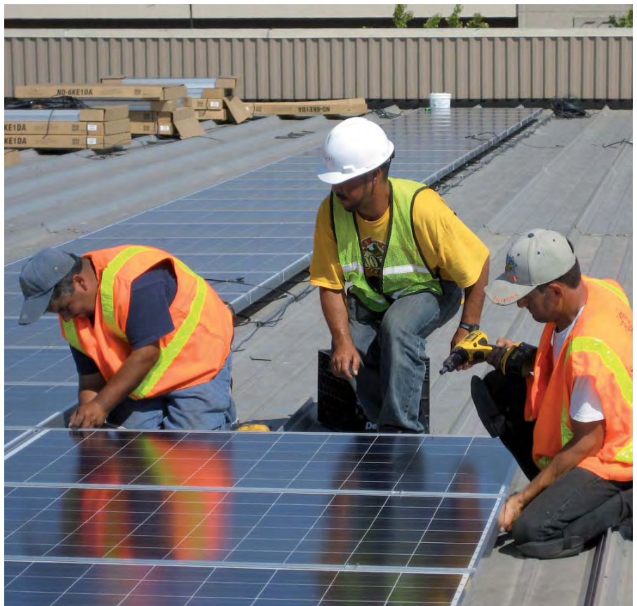
За счет установки солнечных панелей жители домов на 10 процентов покрывают потребности в электроэнергии. Фото © Компания «Биориджинал»
